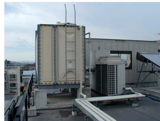
給排水・空調設備
